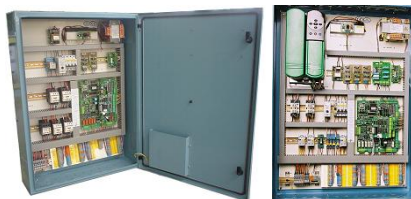
Εικόνα 12 Ηλεκτρονικοί πίνακες ανελκυστήρα
